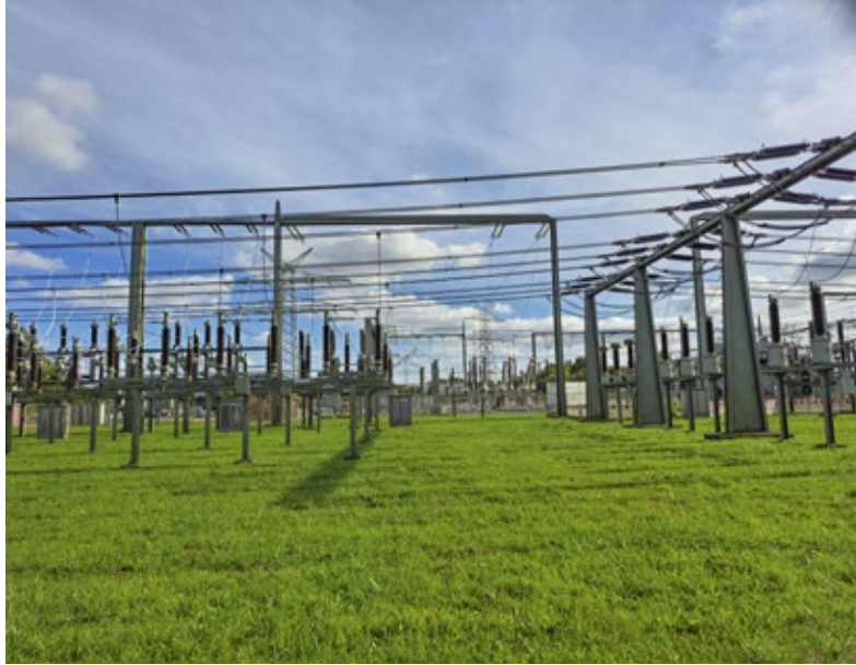
Das Umspannwerk Kiel-Süd liegt in der Edisonstraße. Neu geplant ist ein weiteres Umspannwerk südlich von Meimersdorf oder zwischen Schlüsbek und Rönne.
